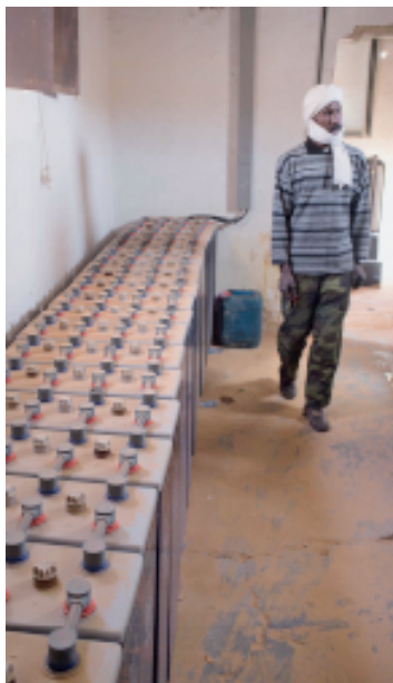
Hôpital de Smara : la salle des batteries
